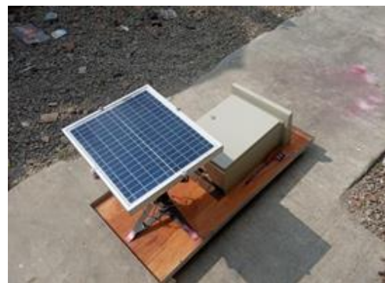
Gambar 5. Pengujian Panel Surya
